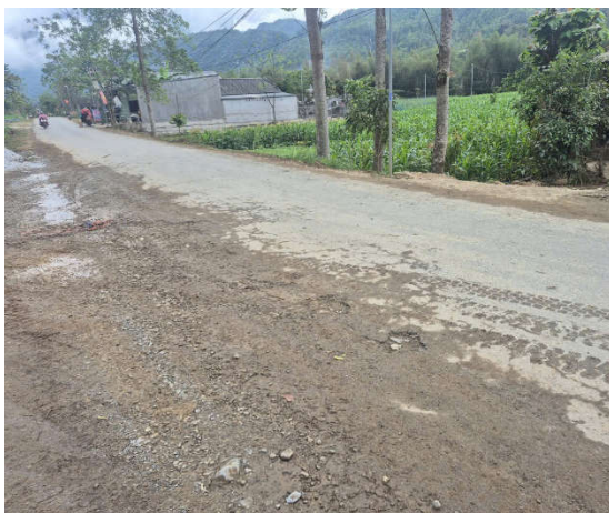
Hình ảnh hiện trạng hư hỏng Km57+600
