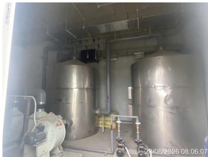
Hình 3.8 Hình hệ thống xử lý mùi trạm xử lý nước thải tại trạm XLNT tập trung
