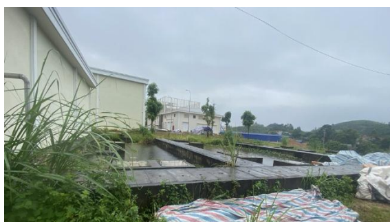
Bể xử lý
