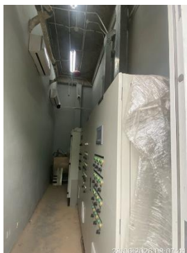
Tủ điện điều khiển ở nhà điều hành
