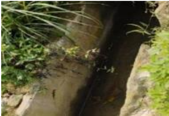
Hiện trạng tường kênh bị vỡ
