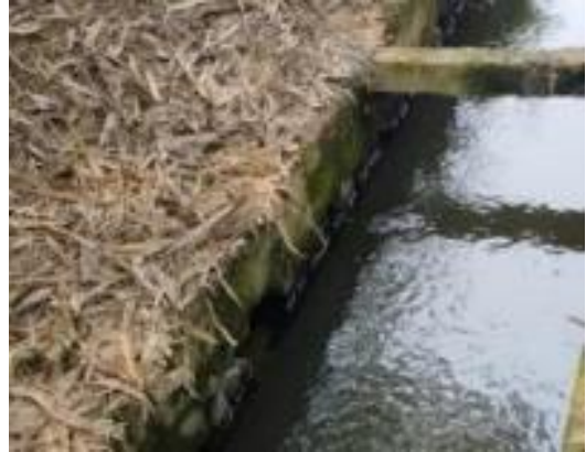
Hiện trạng kênh bị bong tróc, nứt vỡ
