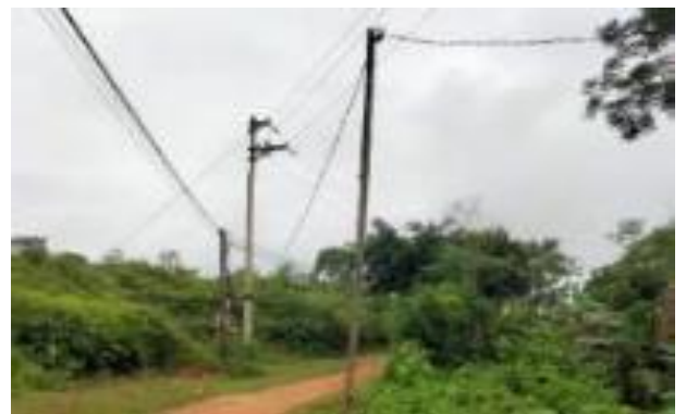
Đường điện trung và hạ thế dọc tuyến
