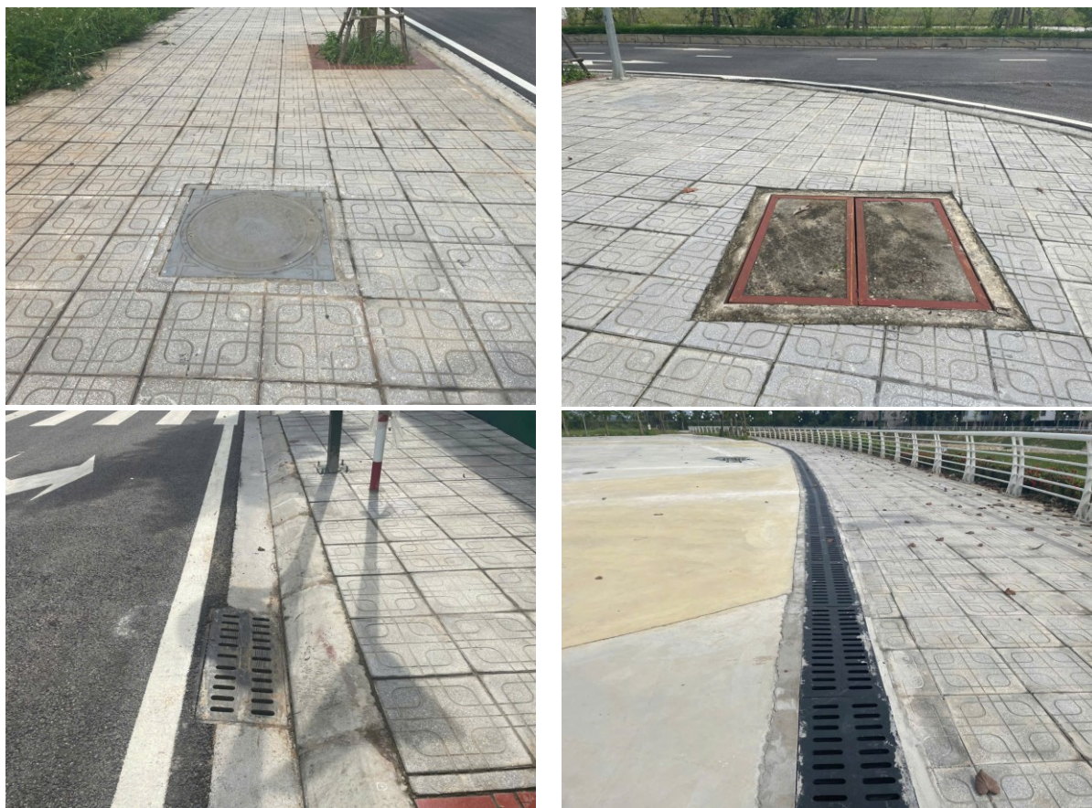
Hình 3.2. Một số hình ảnh hệ thống thoát nước mưa
