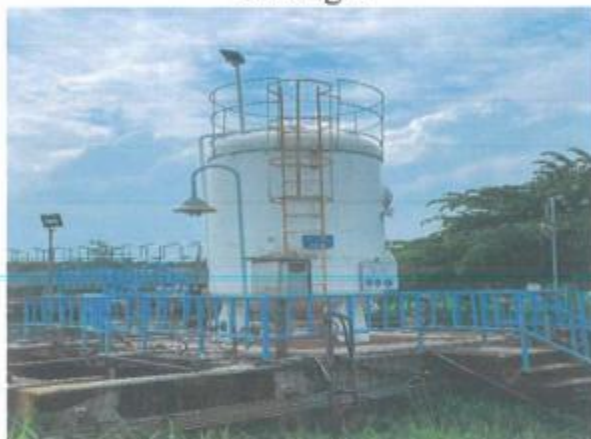
Bể chứa hóa chất trung hòa
