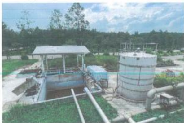
Bể thu gom nước thải
