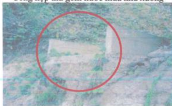
Miệng cửa xả nước mưa ra sông Lô
