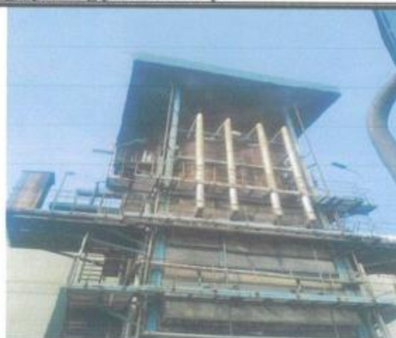
Thiết bị lọc bụi cơ khí lò hơi động lực
