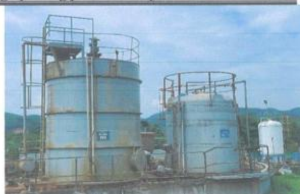
Bể chứa hóa chất xử lý
