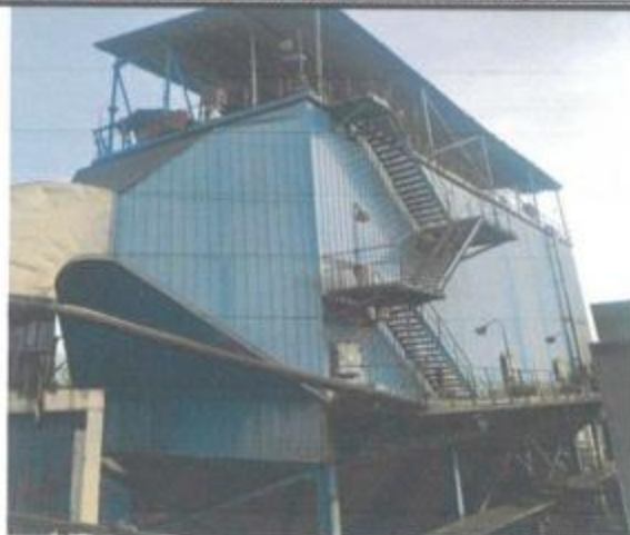
Thiết bị lọc bụi tĩnh điện lò hơi động lực
