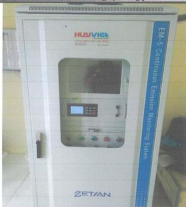
Hình 3.33. Hình ảnh hệ thống quan trắc khí thải tự động
