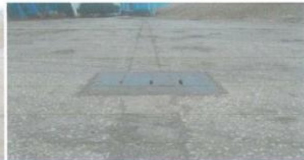
Hố ga thu nước mưa bãi chứa dăm gỗ
