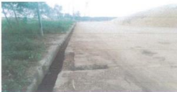
Mương thu nước mưa bãi chứa dăm gỗ
