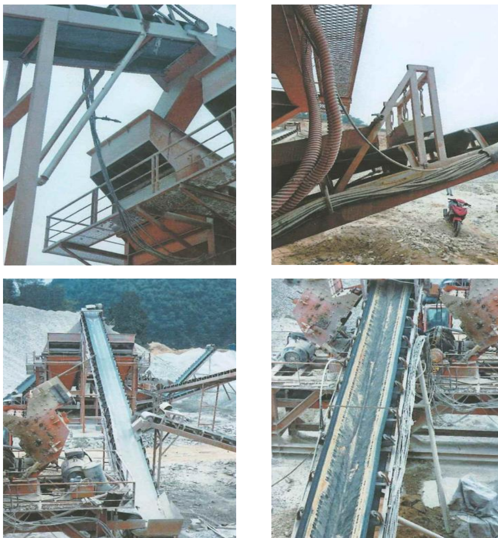
Hình 3.4. Hệ thống phun nước dập bụi tại Trạm nghiền sàng 120 tấn/h
