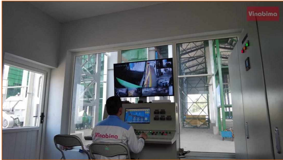
Việc vận hành lò đốt được điều khiển, giám sát, kiểm soát thông qua hệ thống SCADA đặt tại phòng điều khiển.
