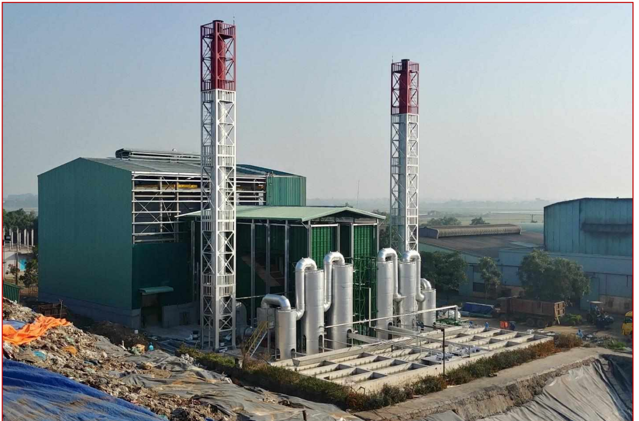
Lò đốt rác sinh hoạt RS-Vinabima công suất đốt 4000kg/giờ x 2 lò tại công ty Urenco 11, xã Đại Đồng, huyện Văn Lâm, tỉnh Hưng Yên.
