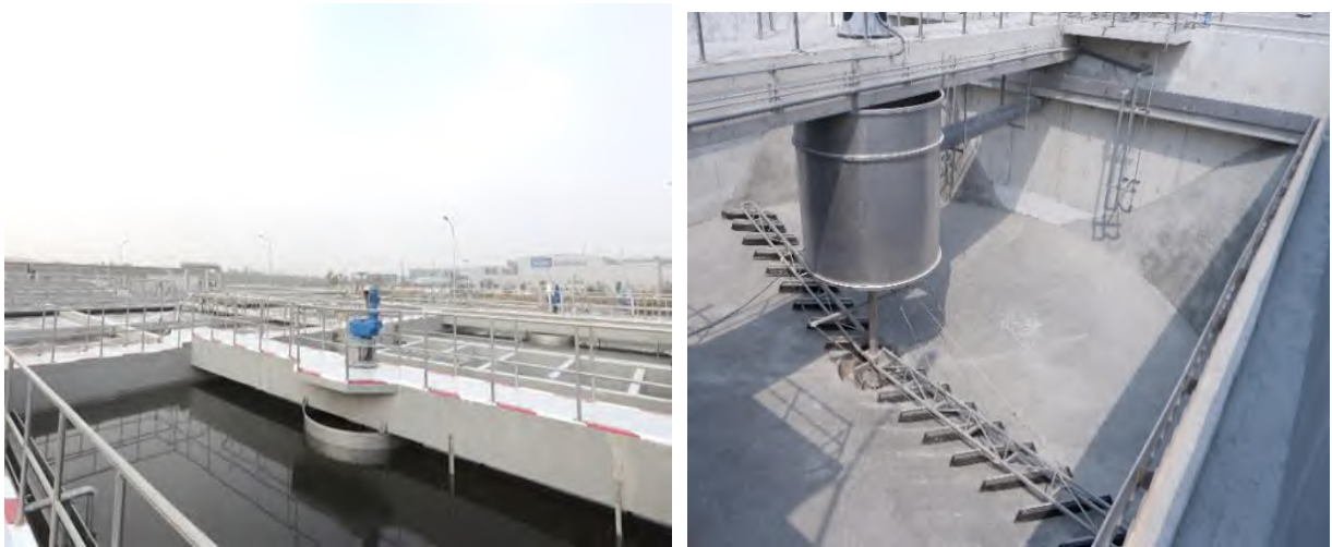
Hình 8. Bể lắng hóa lý
