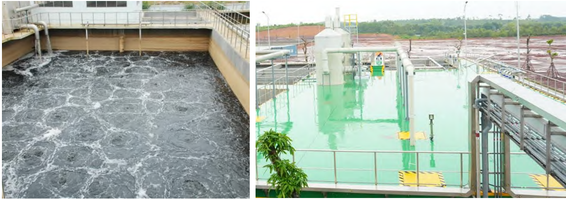
Hình 6. Bể điều hòa
