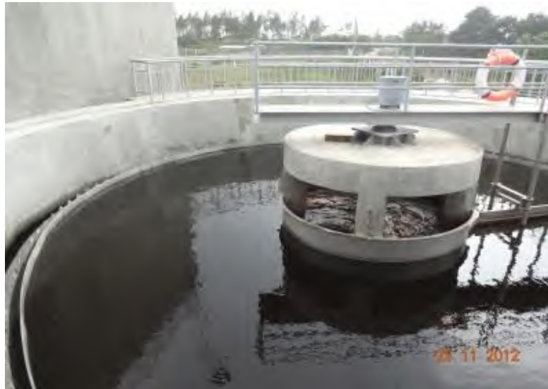
Hình 13. Bể lắng sinh học
